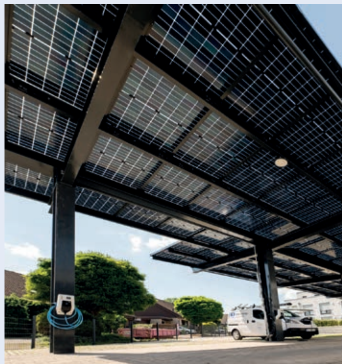
Solarcarportanlage mit 55 kWp und 15 Stellplätze
