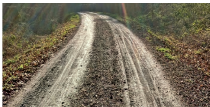
Die Waldchaussee ist nach der Sanierung an vielen Stellen nach wie vor schwer passierbar.
