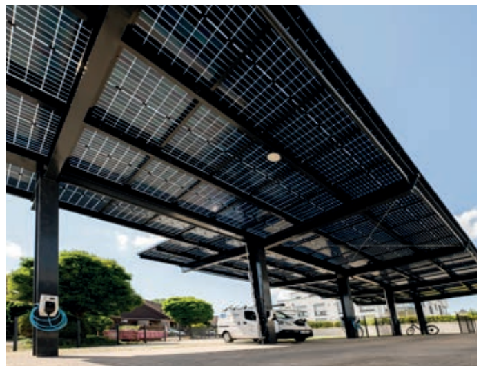
Die Solarparkanlage mit 55 kWp und 15 Stellplätze
