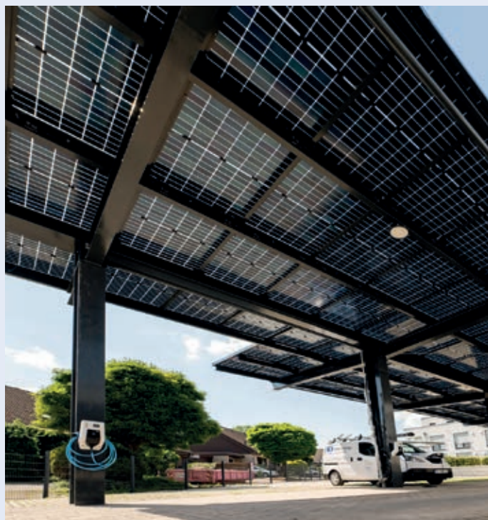
Solarcarportanlage mit 55 kWp und 15 Stellplätze
