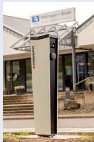
P+B Eingang mit vier neuen AC-Ladesäulen
