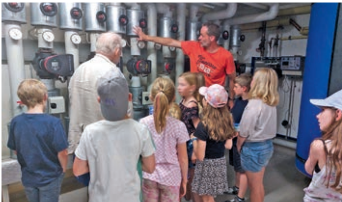
Wie funktioniert die Energieversorgung im Heizungskeller? Die „Klimaforscher“ der Grundschule St. Martin wissen es nun.
