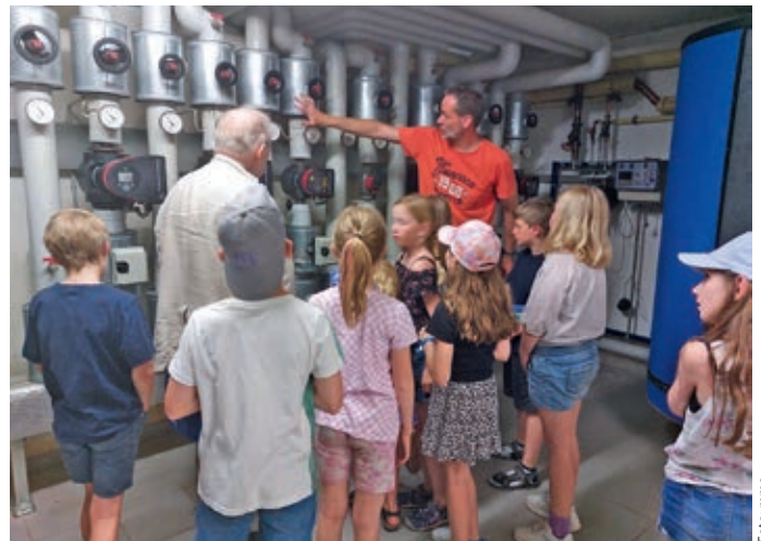
Wie funktioniert die Energieversorgung im Heizungskeller? Die „Klimaforscher“ der Grundschule St. Martin wissen es nun.
