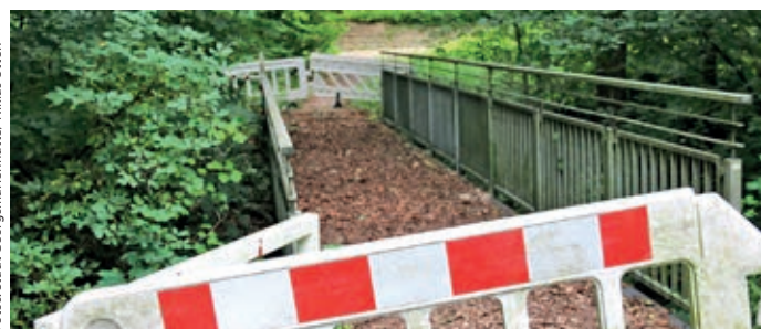
Die Brücke über den Wiesenbach ist weiterhin für eine Nutzung gesperrt. Die Behelfsbrücke ist bereits abgebaut.
