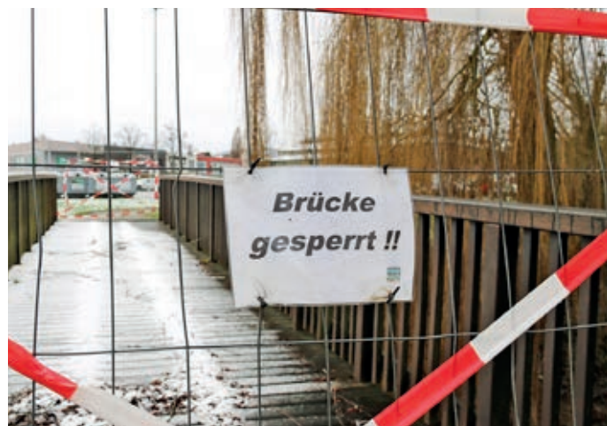
Die gesperrte Düte-Brücke im Georgsmarienhütter Zentrum wird nicht ersetzt, sondern abgerissen. Die Sperrung erfolgte aufgrund des maroden Zustandes des Bauwerkes.
