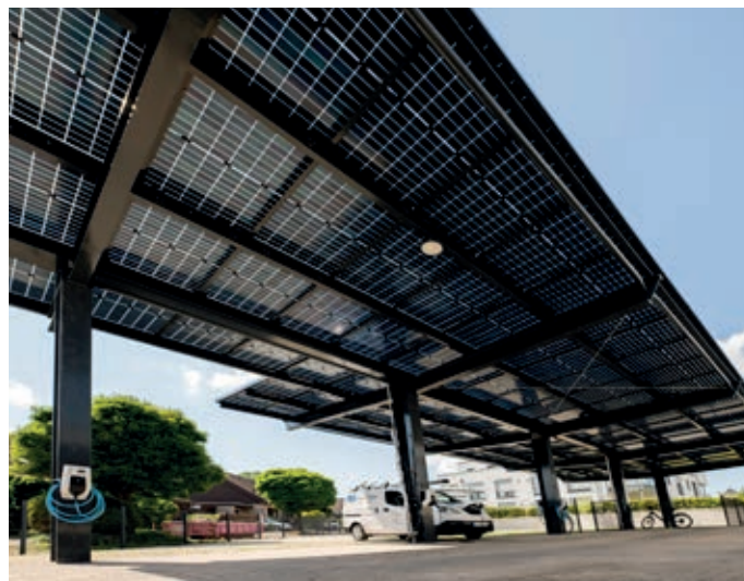
Die Solarparkanlage mit 55 kWp und 15 Stellplätzen.
