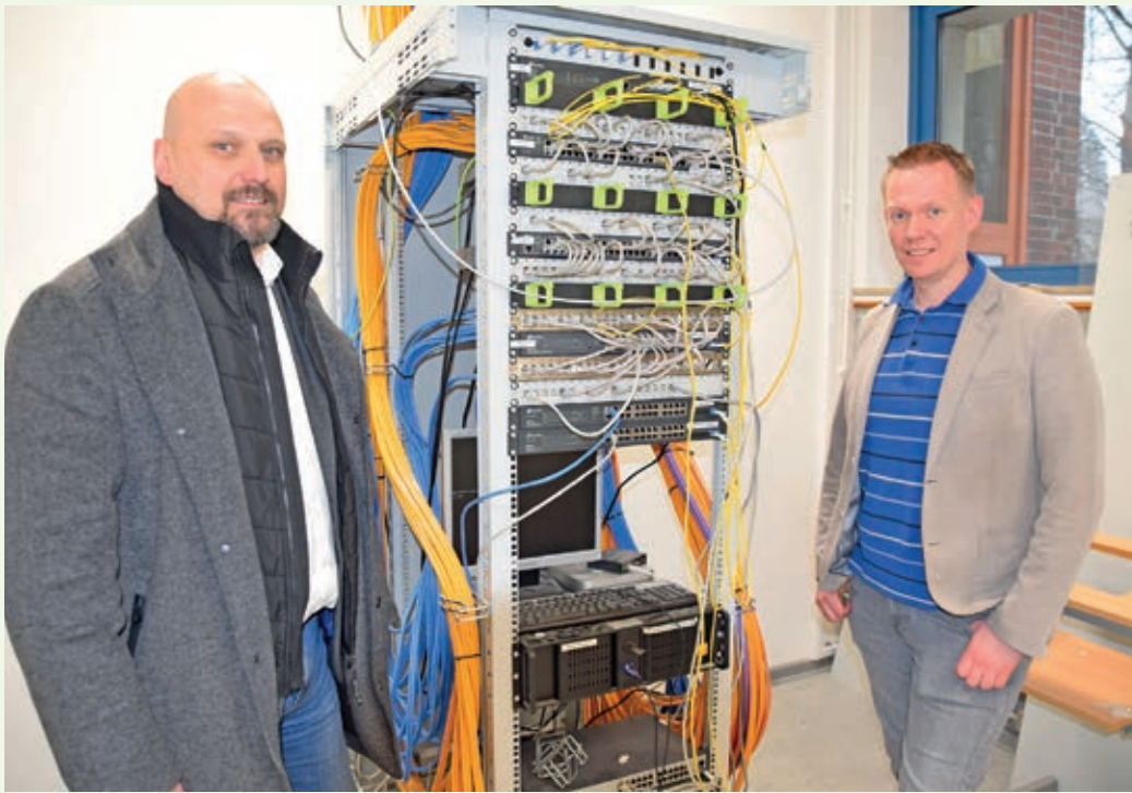
Am Serverschrank laufen alle Netzwerk-Drähte zusammen: Anton Hornstein und Stephan Seestern-Pauly (r.) freuen sich, dass Modernisierung und Umbau an der Regenbogenschule so gut funktioniert haben.
